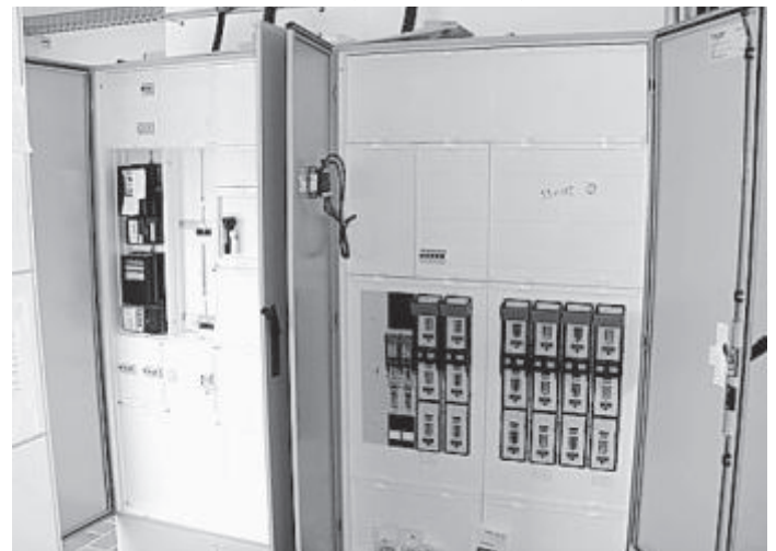
Die neuen Verteilerschränke
