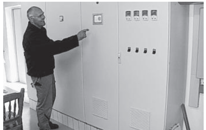
Klärwärter Werner Prochazka vor der neuen Gebläsesteuerung
