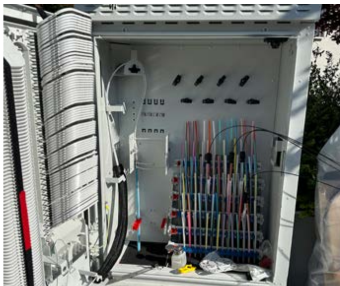
In den Glasfaser-Verteilerkästen werden die Hausanschlüsse ans Glasfasernetz angebunden
