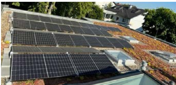
PV-Anlage auf dem Krippenneubau
