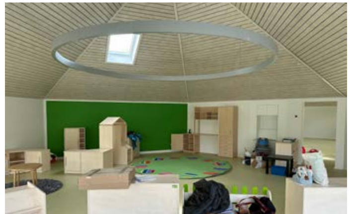
Neue Leuchten in den Gruppenräumen des Bestandsgebäudes
